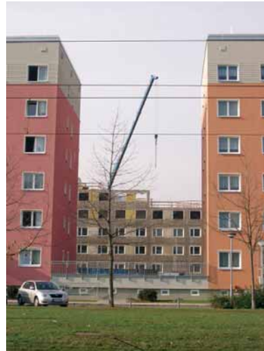
Abb. 12: Der zunehmende Wohnungsleerstand in Ostdeutschland macht den Rückbau insbesondere bei Mehrfamilienhäusern notwendig.
